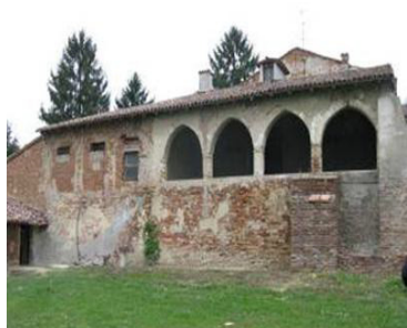
Muratura in fase di collasso
