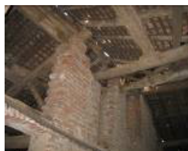
Terzere in legno con appoggi degradati
